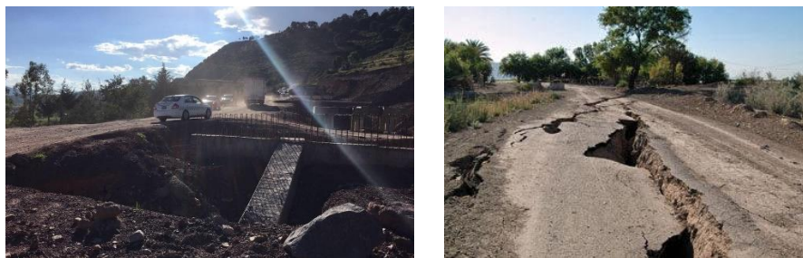
Figura 4.8 y 4.9 Hundimientos en la carretera Acambay-Palmillas impiden el paso de vehículos y la continuación de obra de SCT (Milenio, 2017)
